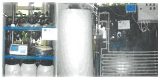
Instalație modulară de proces
