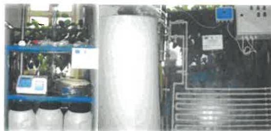
Instalație modulară de proces
